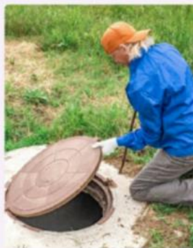
Hình 32.7. Một hố gas vừa được mở nắp
